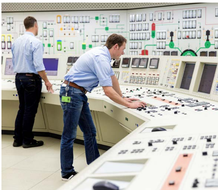
Der Kommandoraum ist Haupteinsatzort des Technikers HF «Grossanlagenbetrieb».
